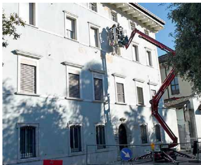
• I tecnici scrostano la facciata principale di villa San Pietro FOTO GALAS
